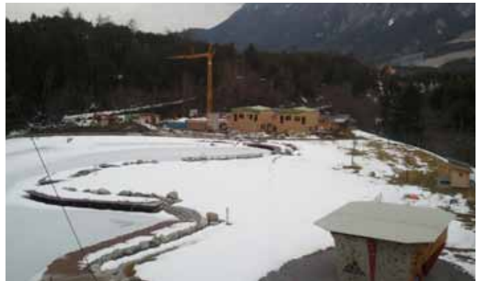
Auf diesem Foto herrschte noch Winterschlaf, obwohl auf der Baustelle im Hintergrund 32 Doppelbettzimmer der Komfortklasse entstehen.
